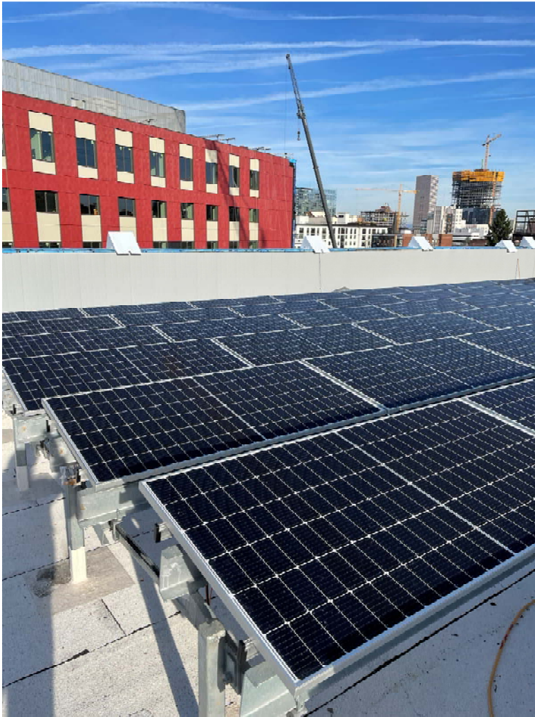
PV Solar Array
